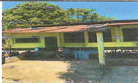
Foto 4: TECHO DE CORREDORES DE LAS AULAS
